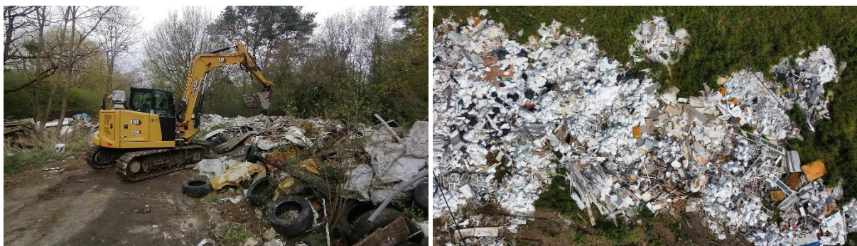
Figure 6 : Photographie et cliché drone pris à l'occasion des tests (Crédits : Ecogeos et Géodunes)
